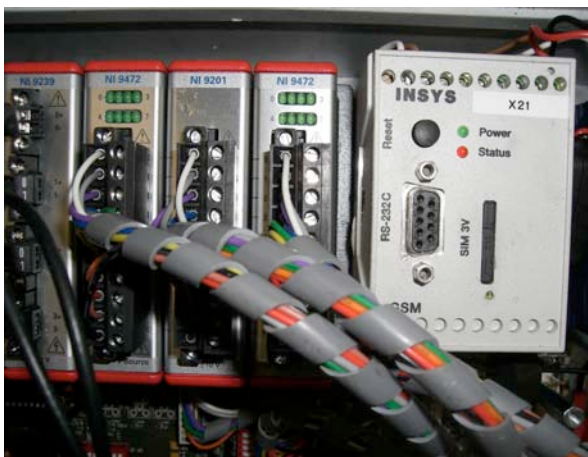
E-GOMS II - modules & communication module (here: GSM-Modem)
